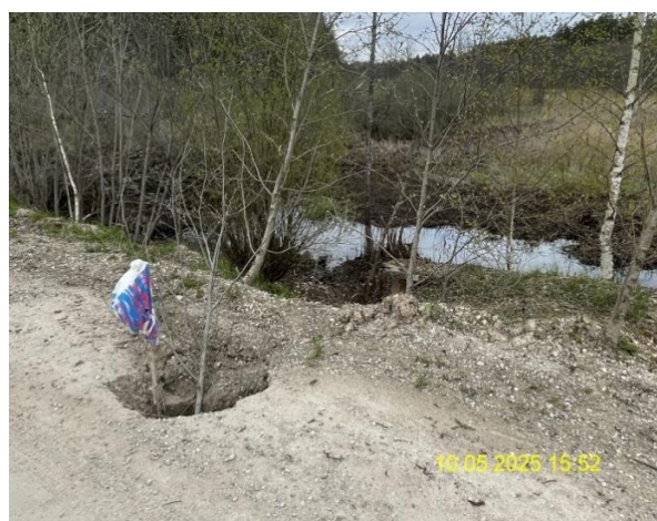
Рисунок I-4.2 – Река Андоловка (размыв дорожного полотна)
